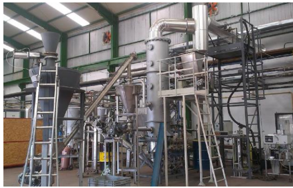
Planta piloto de gasificación con lecho burbujeante de 100kWt (CEDER)
